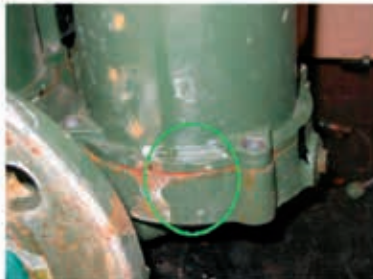
Утечка из отвода конденсата
