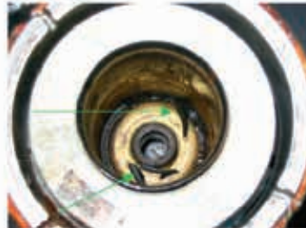
Поврежденный сальник корпуса двигателя
